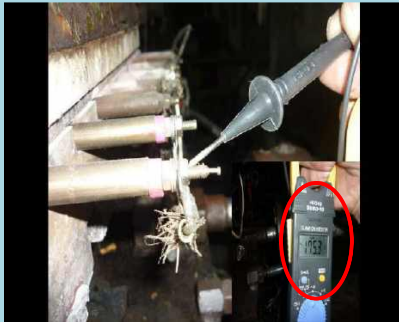
以三用電錶量測電熱器，量測電壓為175.3伏特
